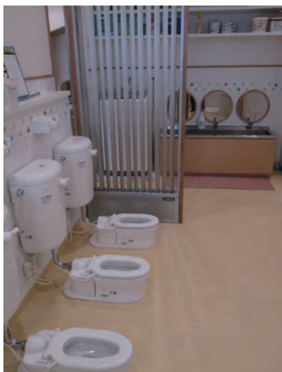
トイレの設置状況
